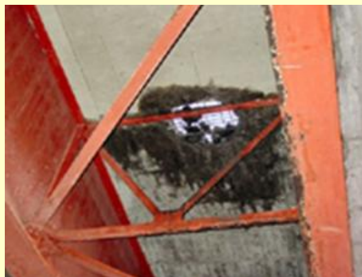
健全度 IV : 参考写真 (床版抜け落ち)
