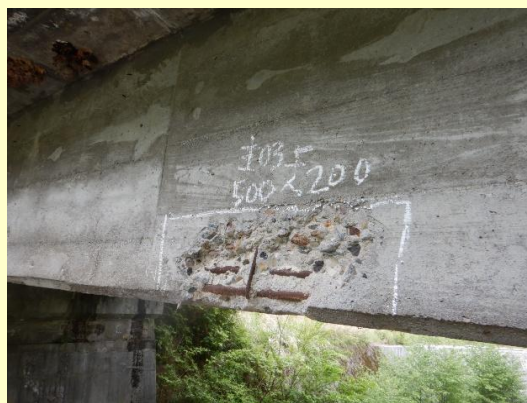
健全度 II : 泉下橋 (鉄筋露出)
